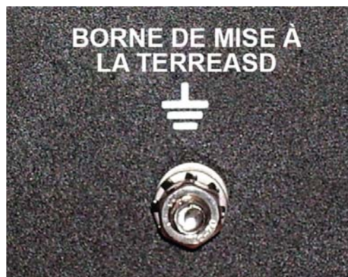
Figure 7 - Mise à la terre du générateur
